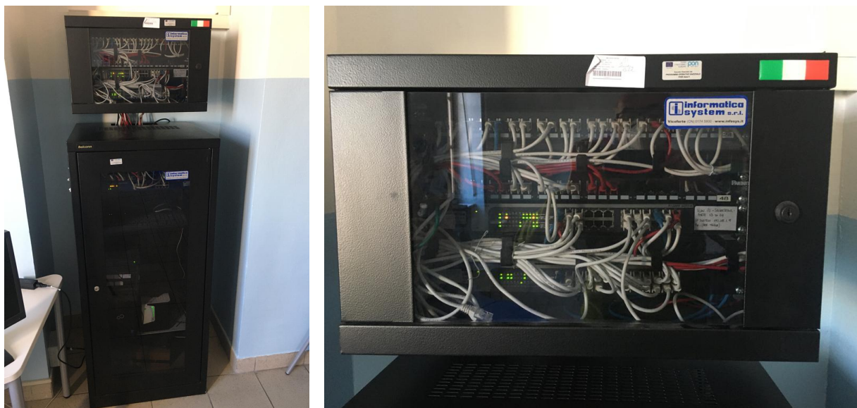
Rack al piano primo
